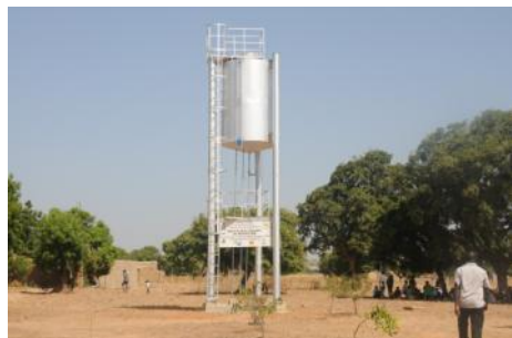
le château d'eau de 10 m3
