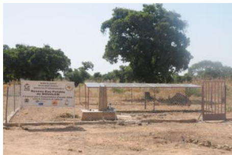
la pompe électrique alimentée par panneaux solaires
