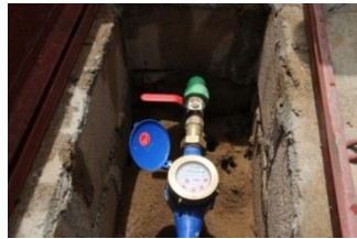
Compteur d'eau Collège
