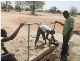
Le point d'eau près du collège (2*2 robinets)
