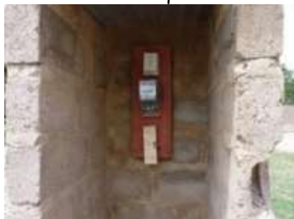
Arrivée d'électricité compteur
