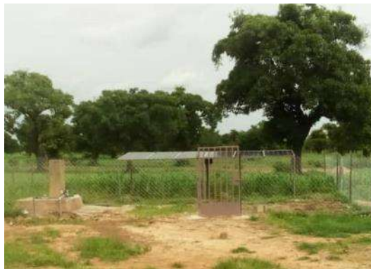
Le forage avec la pompe immergée et les 6 panneaux solaires
